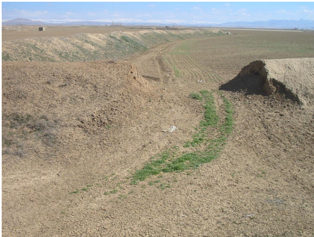
شکل ۶۴- تخریب جزئی دیواره کانال اصلی در محل جدا شدن کانال پخش اول P4-1 از کانال گسترشی چهارم G4 (فرهادی، ۱۳۹۷)
