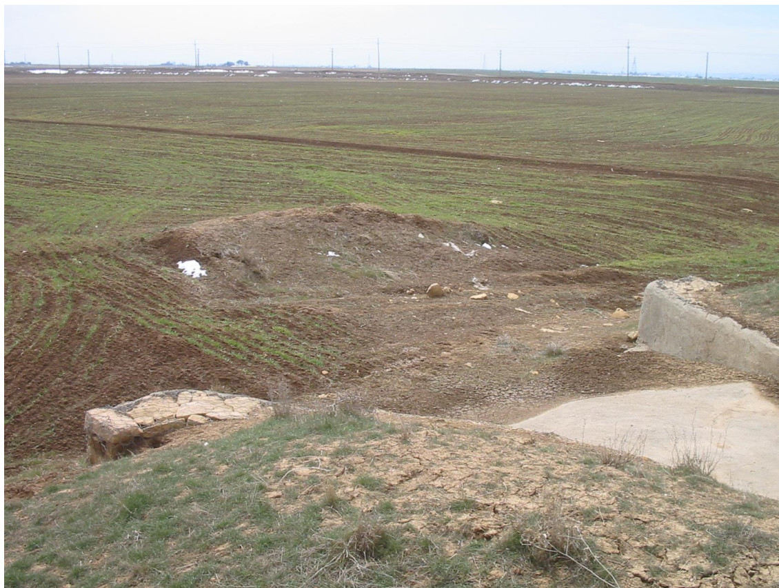
شکل ۳۱ - تخریب جزئی سنگ‌چین و سپر حفاظتی دروازه کانال پخش سوم P2-3 از کانال گسترشی دوم G2 (فرهادی، ۱۳۹۷)
