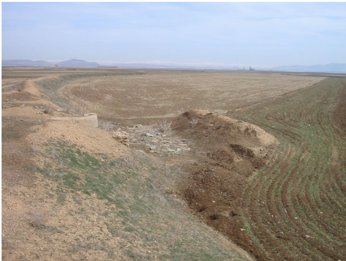
شکل ۴۳- تخریب جزئی سپر حفاظتی دروازه کانال پخش اول P3-1 از کانال گسترشی سوم G3 (فرهادی، ۱۳۹۷)
