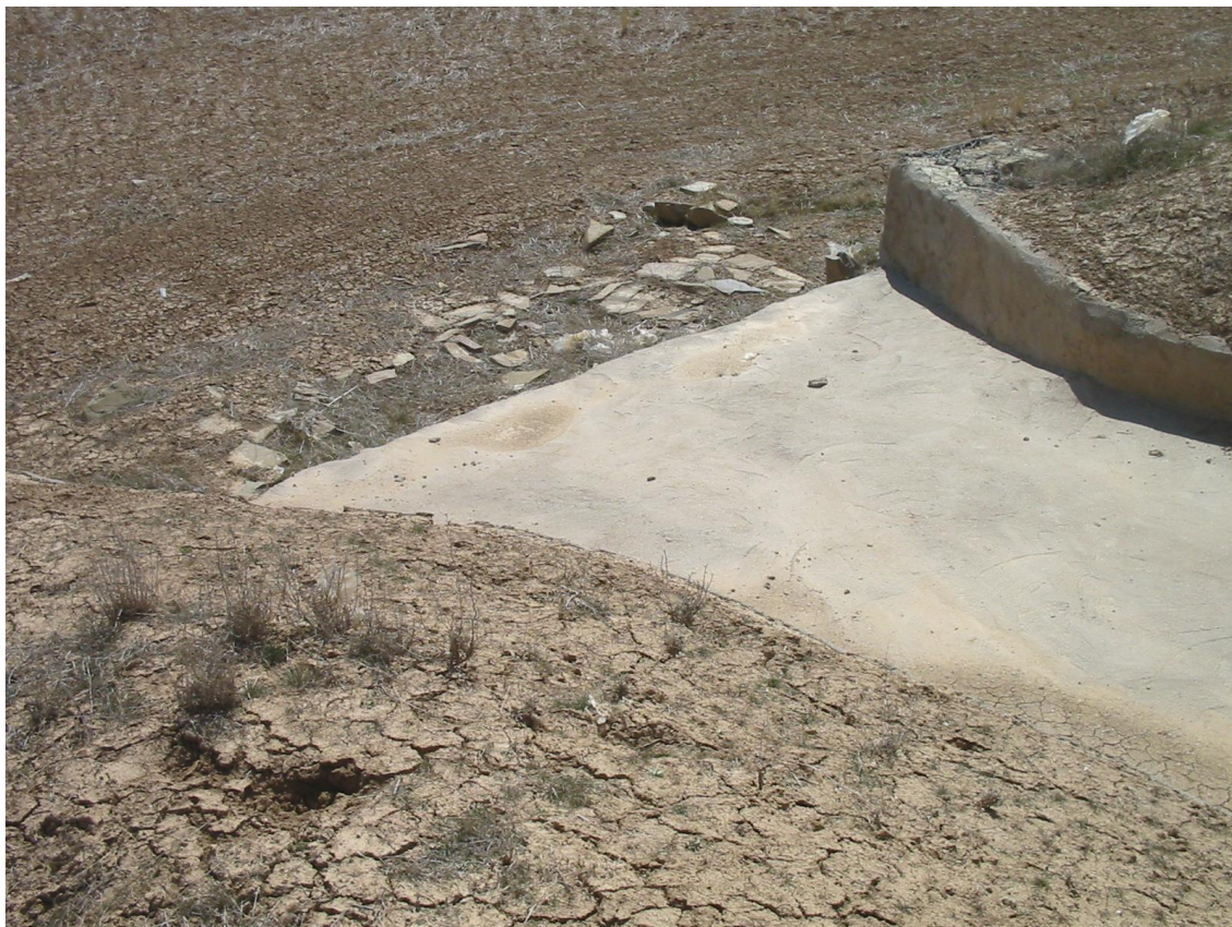
شکل ۵۴- تخریب جزئی سنگ چین حفاظتی دروازه کانال پخش دوم P3-3 از کانال گسترشی سوم G3 (فرهادی، ۱۳۹۷)
