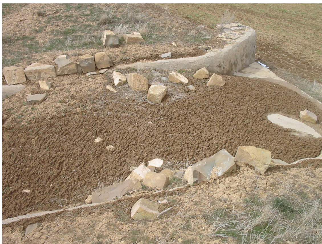
شکل ۲۴- تخریب جزئی دیواره دروازه کانال پخش دوم P2-2 از کانال گسترشی دوم G2 (فرهادی، ۱۳۹۷)
