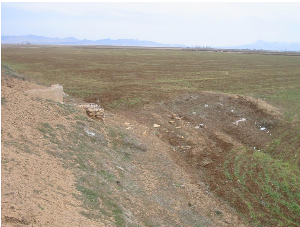
شکل ۳۰ - تخریب جزئی سنگ‌چین و سپر حفاظتی دروازه کانال پخش سوم P2-3 از کانال گسترشی دوم G2 (فرهادی، ۱۳۹۷)
