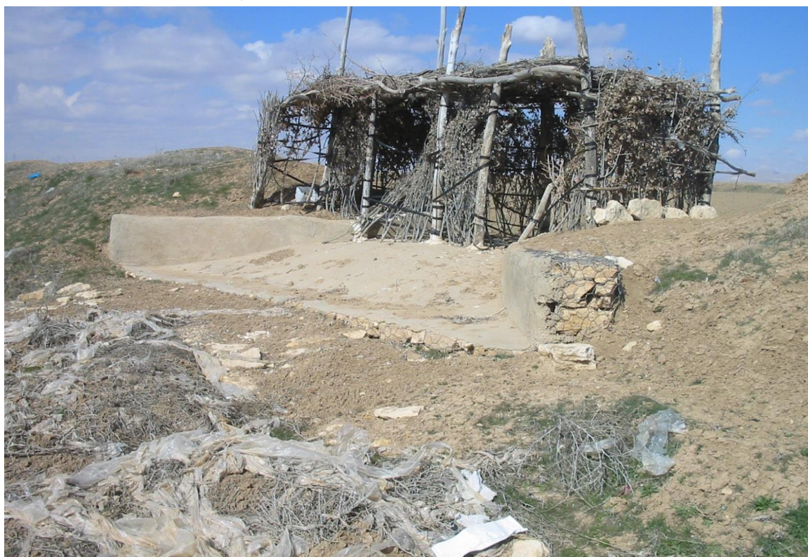
شکل ۷۰- تخریب جزئی سنگ‌چین حفاظتی دروازه کانال پخش اول P4-1 از کانال گسترشی چهارم G4 (فرهادی، ۱۳۹۷)
