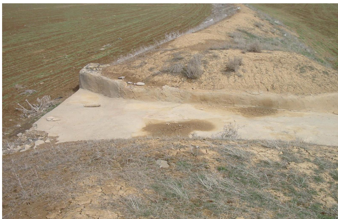
شکل ۲۹- تخریب جزئی سنگ‌چین حفاظتی دروازه کانال پخش دوم P2-2 از کانال گسترشی دوم G2 (فرهادی، ۱۳۹۷)
