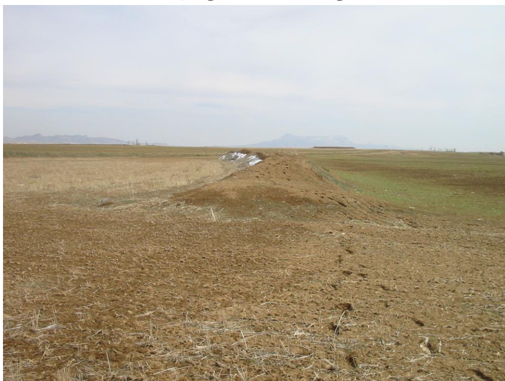
شکل ۱۶- تخریب کلی خاکریز کانال گسترشی دوم G2 (فرهادی، ۱۳۹۷)
