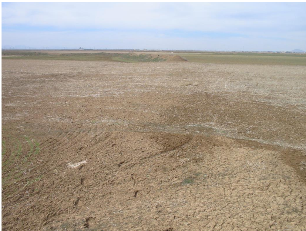
شکل ۱۵- تخریب کلی خاکریز کانال گسترشی دوم G2 (فرهادی، ۱۳۹۷)
