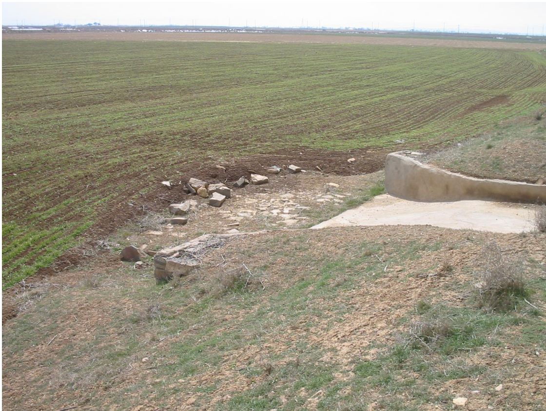
شکل ۲۳- تخریب جزئی سنگ‌چین حفاظتی دروازه کانال پخش اول P2-1 از کانال گسترشی دوم G2 (فرهادی، ۱۳۹۷)
