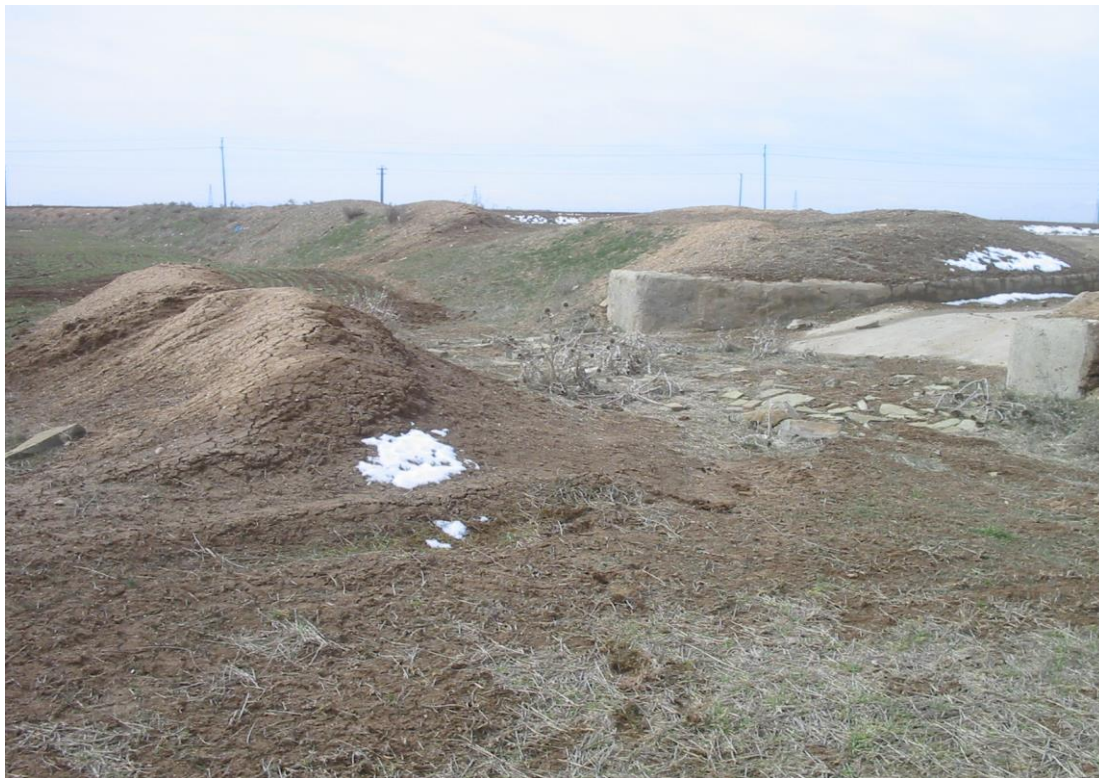
شکل ۴۴- تخریب جزئی سپر حفاظتی دروازه کانال پخش اول P3-1 از کانال گسترشی سوم G3 (فرهادی، ۱۳۹۷)
