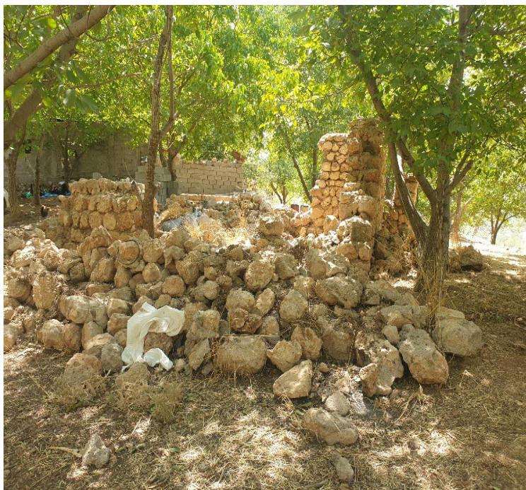
شکل ۱۰- تخریب دیواره خانه سنگی در افراز لغزش
