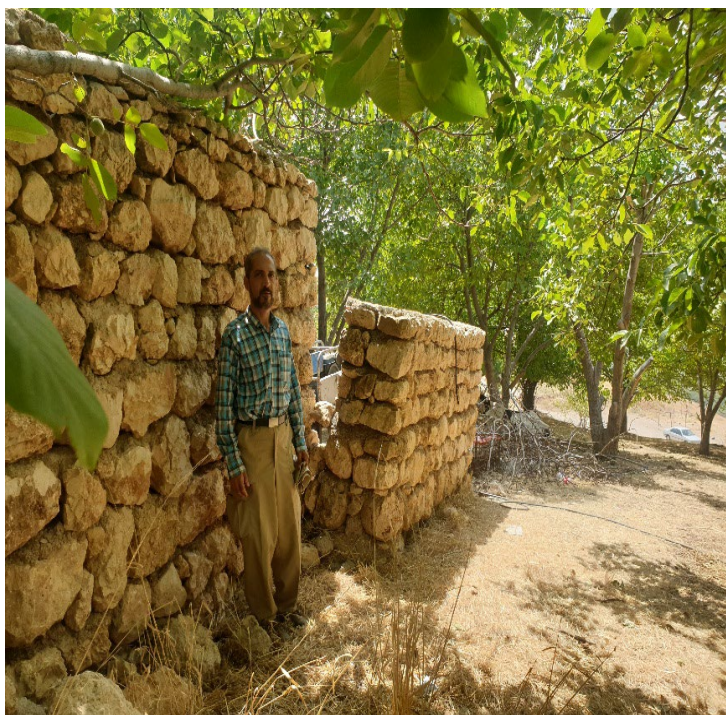
شکل ۱۱- کج شدگی دیوار بنای سنگی در افراز لغزش
