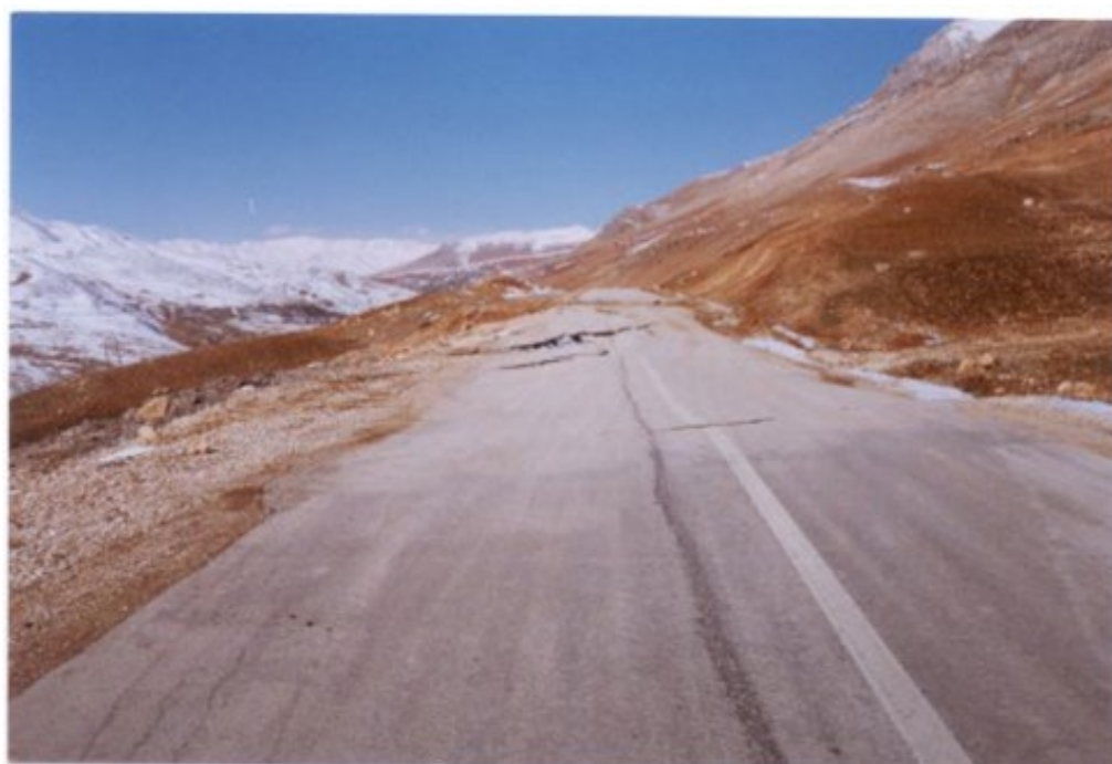
شکل ۱۳- نشست و تخریب جاده در اثر وقوع زمین لغزش
