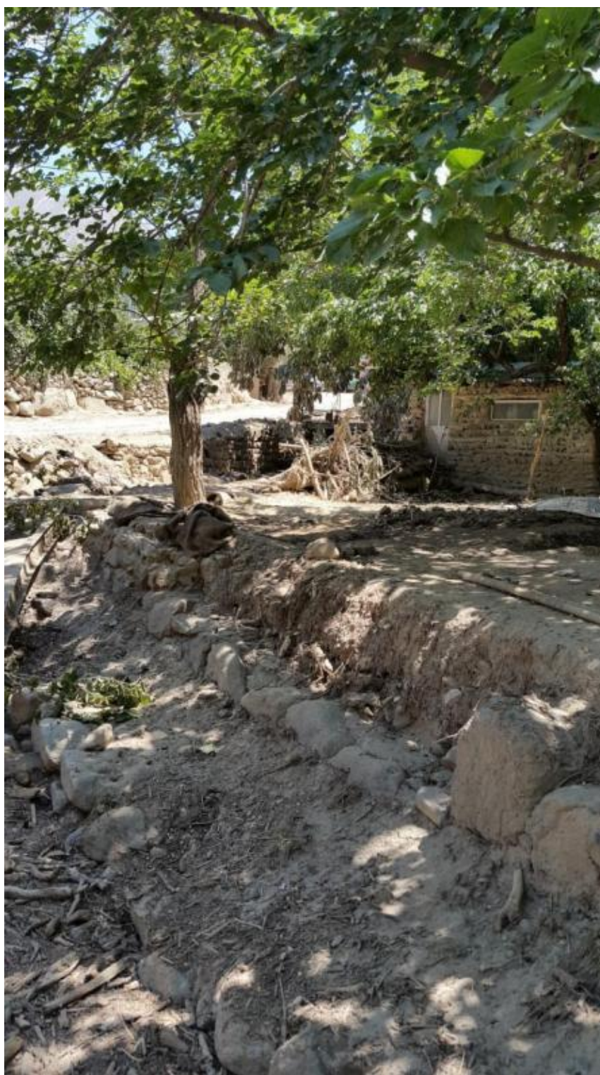
شکل ۴۲- نمایی از دیوار باغ در حریم رودخانه که در اثر سیل تخریب و سنگ‌های آن به پایین‌دست منتقل شده‌اند.
