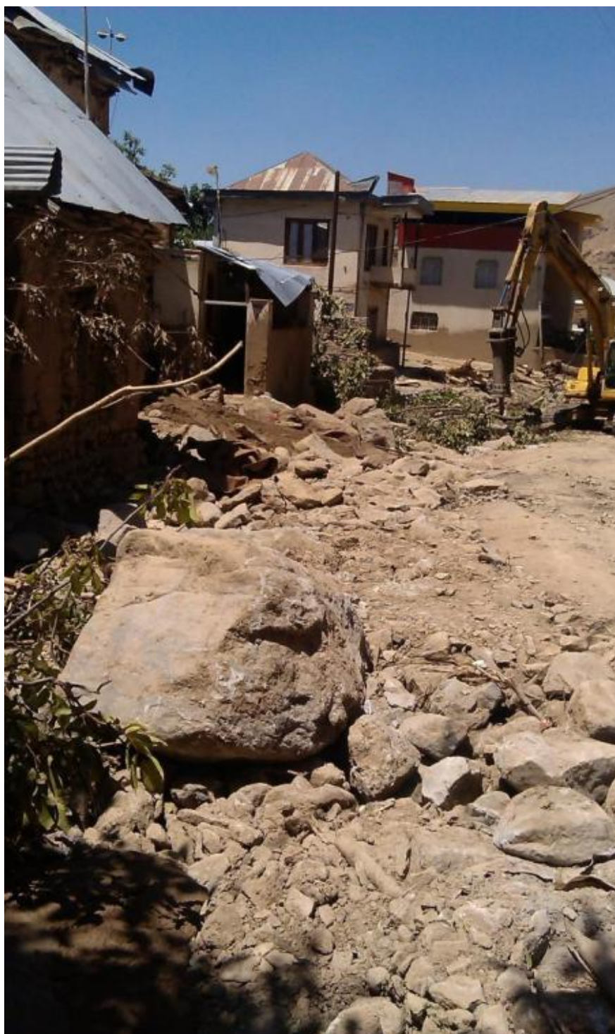
شکل ۱۷- دیوارهای تخریب شده چند واحد مسکونی مجاور آبراهه و یکی شدن بستر رودخانه و حیاط این واحدها
