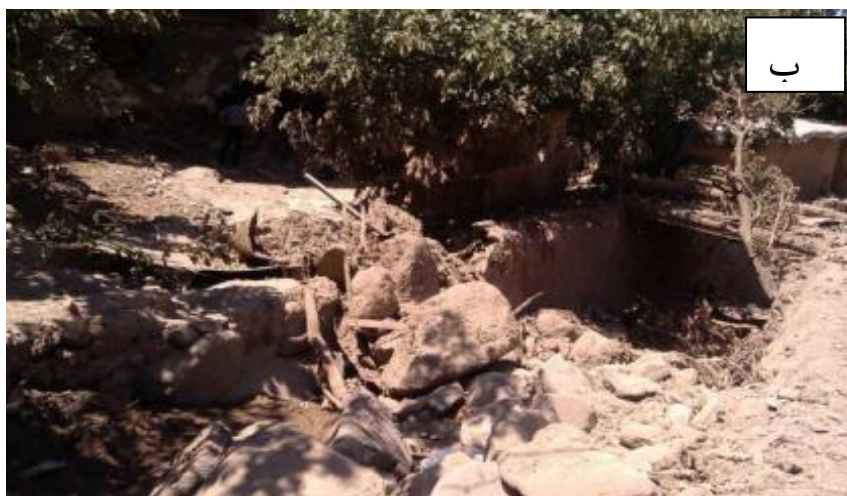
شکل ۲۸- نمایی از بسته شدن دهانه یک پل در وسط روستا (الف دهانه خروجی پل و ب دهانه ورودی آن)
