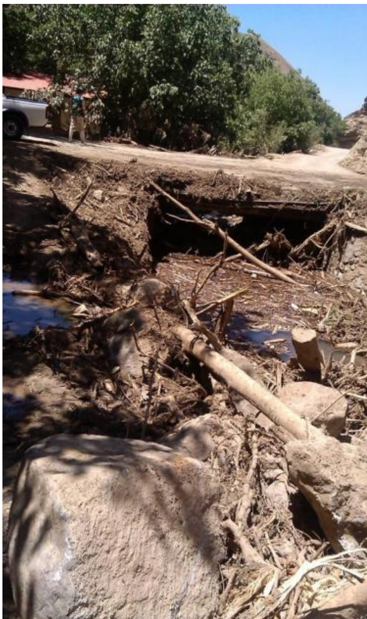
شکل ۳۰- دهانه ورودی پل اصلی روستای سیجان در مسیر رودخانه شمال پر شده از مواد و مصالح حمل شده از رودخانه جنوبی و عبور از روی پل به سمت بالادست
