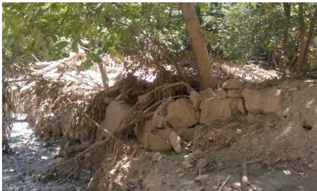
شکل ۴۰- نمایی از دیوار باغ در حریم رودخانه که در اثر سیل تخریب و سنگ های آن به پایین دست منتقل شده اند.
