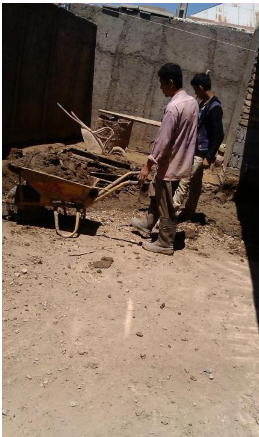
شکل ۱۸- نمایی از ضخامت حدود نیم متری لای برجامانده از سیل در حیاط واحد مسکونی پس از تخریب دیوار و
