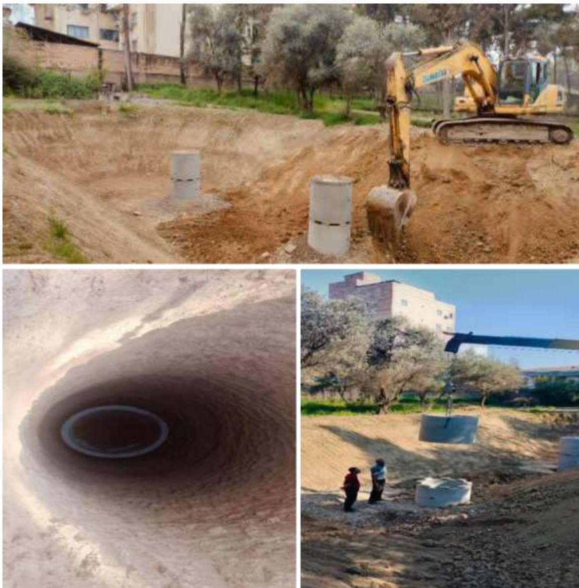
شکل ۳-۲. پروژه استحصال آب باران و چاه تغذیه در محوطه سازمان جهاد کشاورزی گلستان
